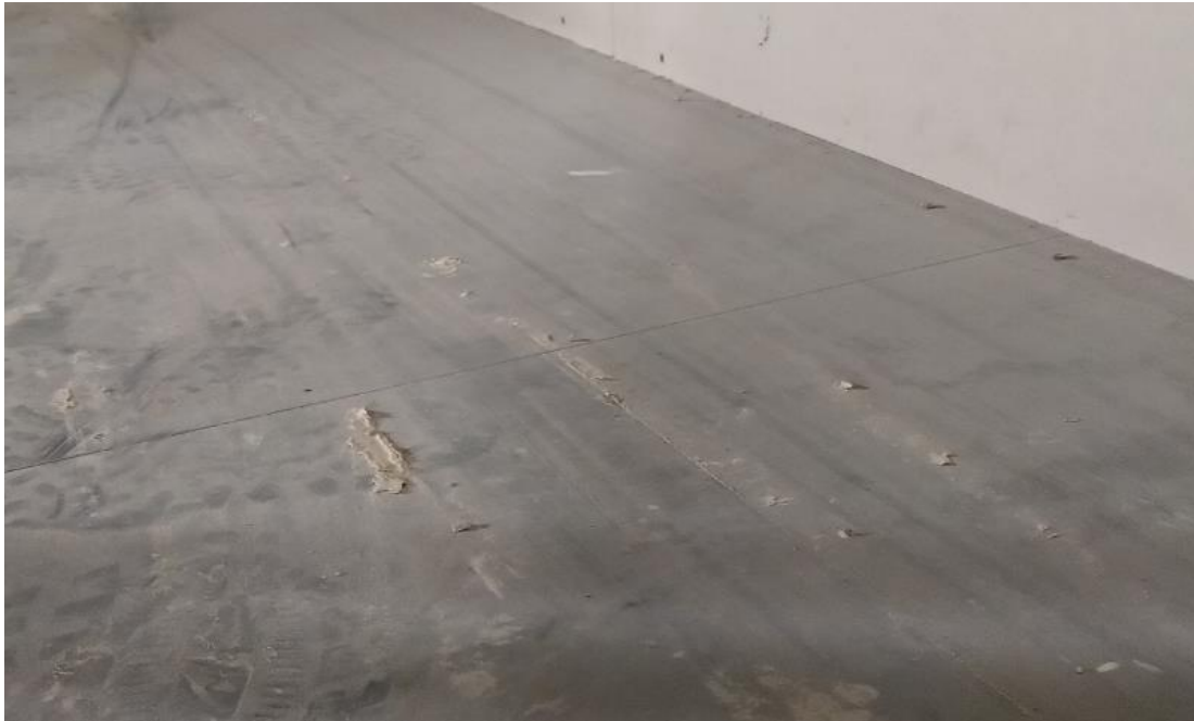
Kuva 1. Lähtötilanteen kuva lattian pölyisestä pinnasta.
