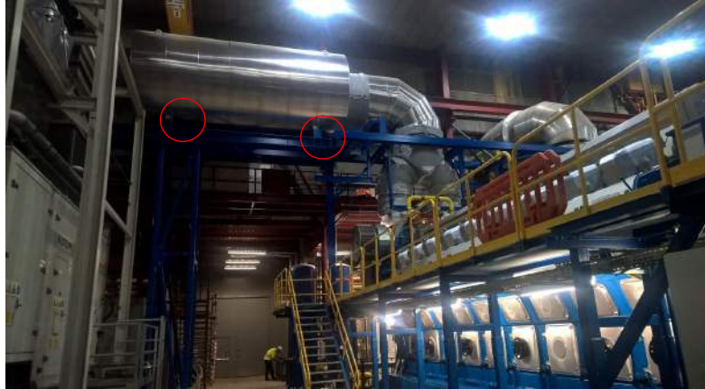
Kuva 4. Pakovaimennin (kuvassa ylhäällä vasemmalla) on asennettu joustavasti voimalaitosrakennuksen sisälle.
